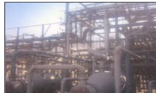
لوله کشی اطراف تجهیزات
