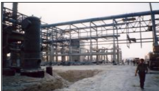
لوله کشی روی راک
