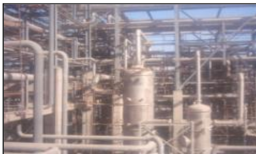
لوله کشی اطراف تجهیزات
