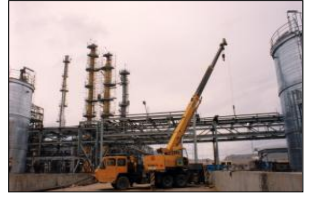
لوله کشی پایپ
