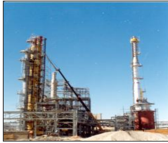
لوله کشی و تاسیسات اطراف تاورها
